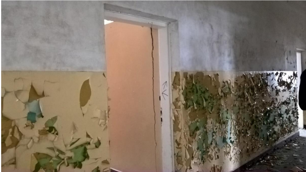
Fot. 7 Odwarstwiająca się farba na korytarzu
