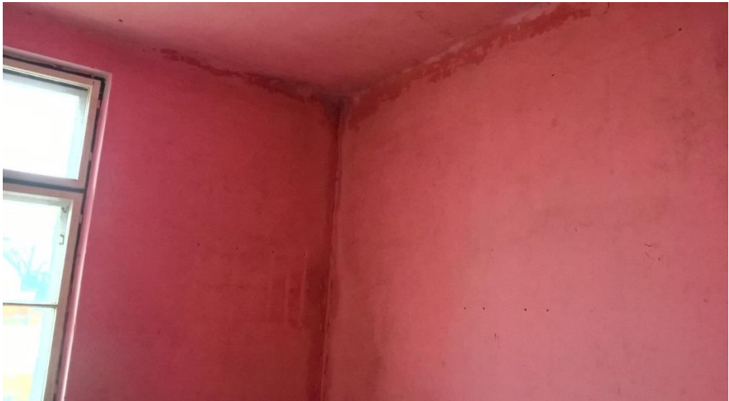
Fot. 5 Zawilgocenie ściany budynku
