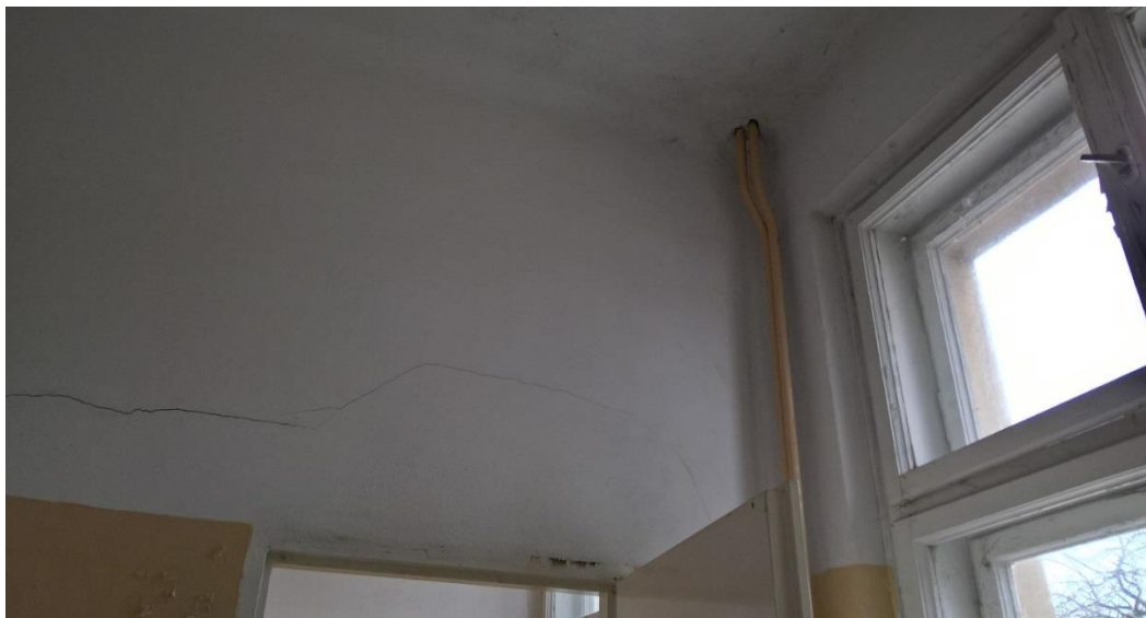
Fot. 6 Zarysowana ściana budynku
