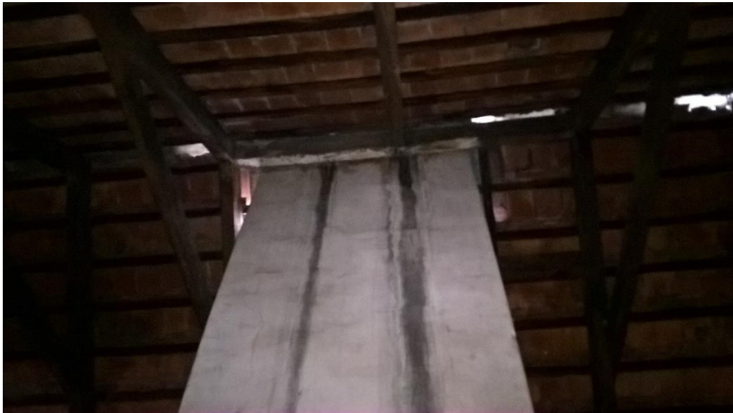
Fot. 8 Zacieki na ścianie komina, nieszczelności w pokryciu dachowym
