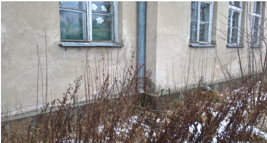
Fot. 9 Nieprawidłowe odprowadzeni wody z dachu
