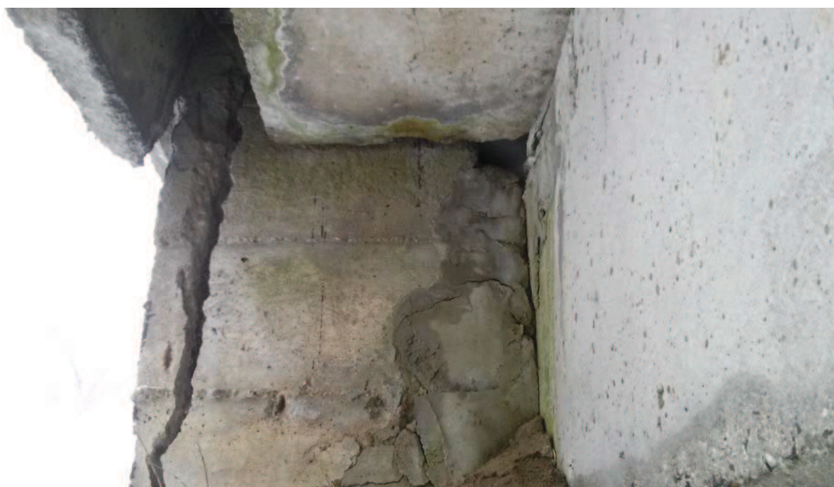
Fot. I.3 Widok na uszkodzone skrzydło
