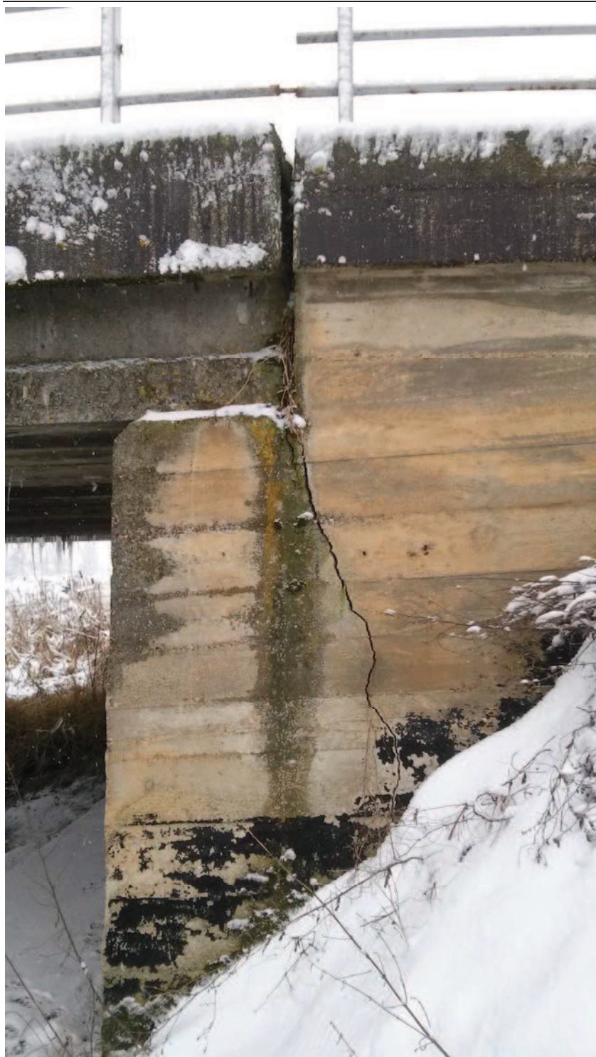
Fot. II.3 Widok na uszkodzone skrzydło
