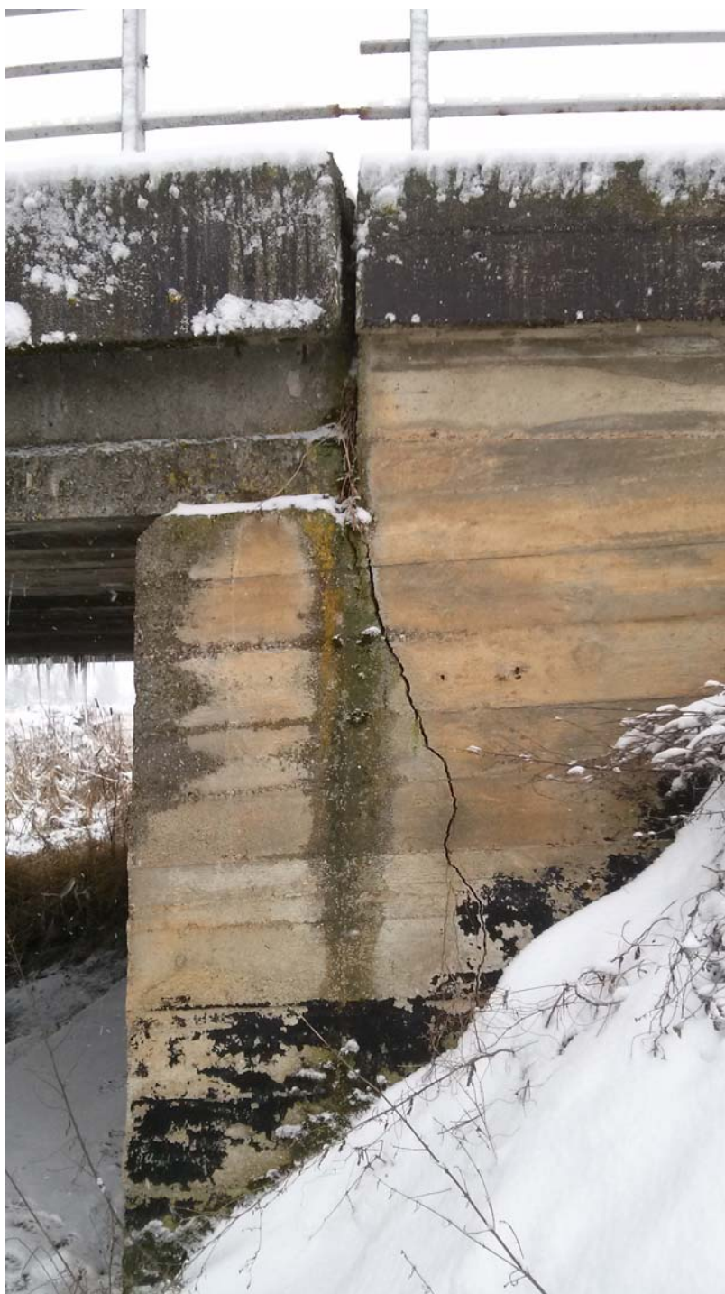
Fot. II.3 Widok na uszkodzone skrzydło
