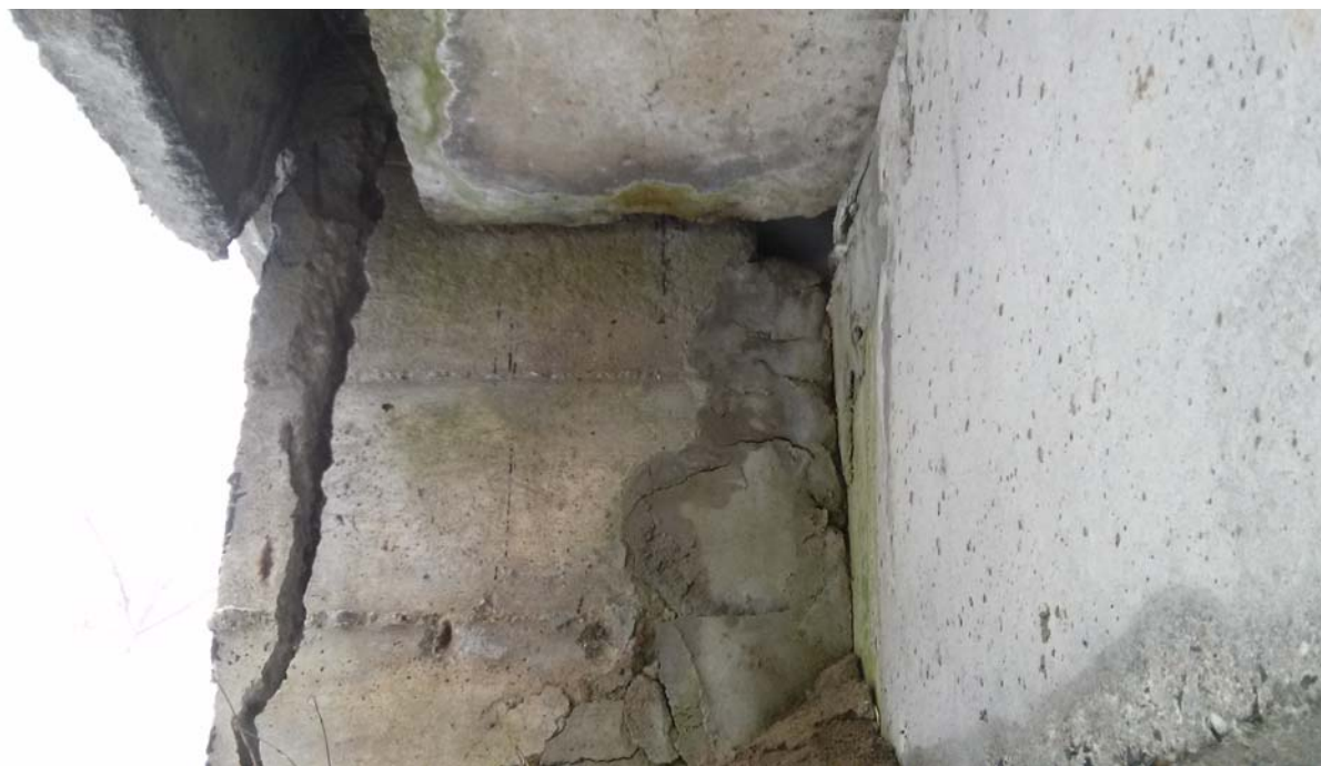
Fot. I.3 Widok na uszkodzone skrzydło
