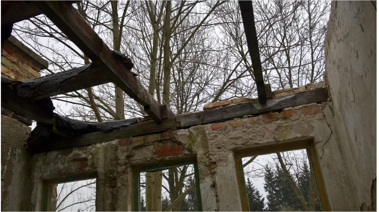
Fot 5 Braki w konstrukcji dachowej, zdegradowane belki dachowe i ściany
