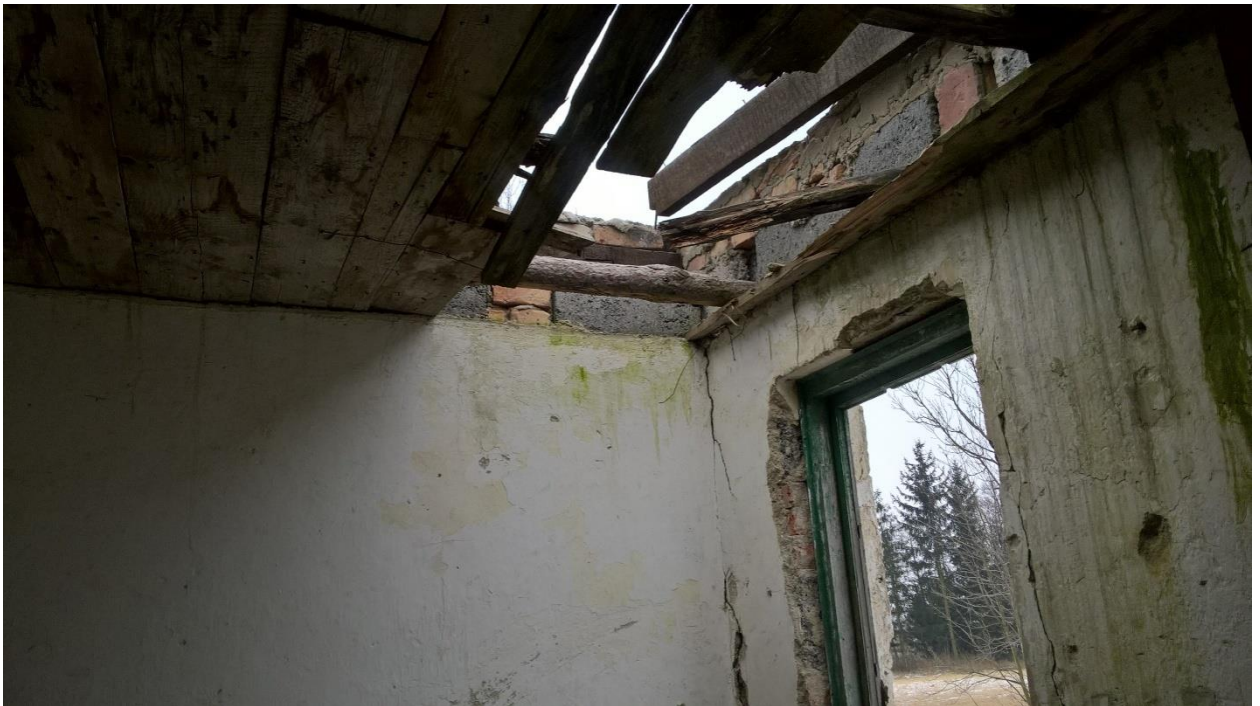
Fot. 6 Braki w konstrukcji dachu, zarysowanie ścian, brak stolarki drzwiowej
